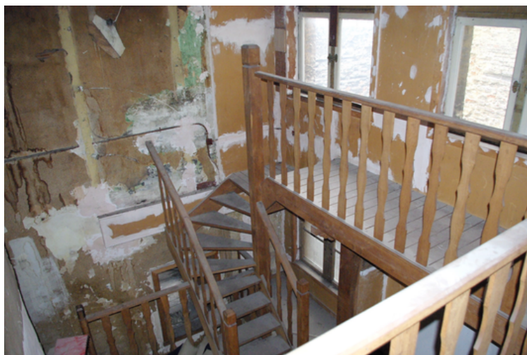
Exemple d'immeuble rénové pour un usage résidentiel (rue du Marché aux Herbes n°8-10) © Ville de Bruxelles
